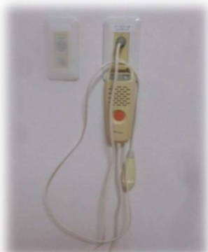
緊急通報装置
